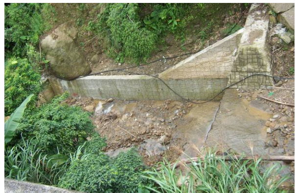
圖 8 新竹 A028 中游護岸工程及土砂堆積情況
