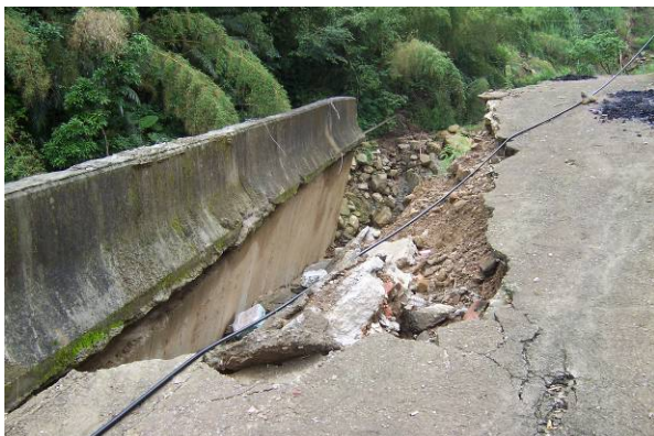
圖 7 新竹 A028 中游保全住戶旁護岸損毀
