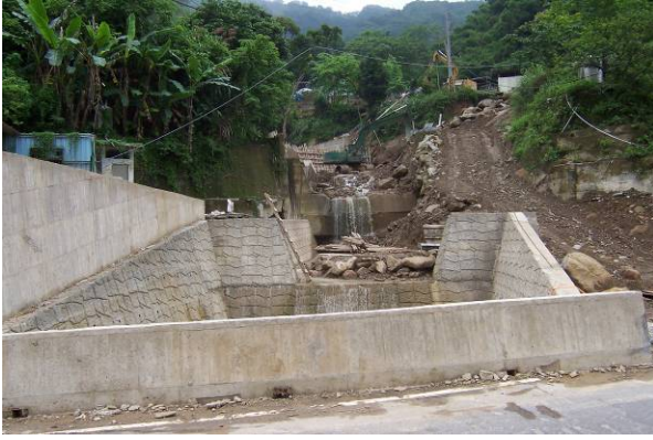
圖 9 新竹 A028 下游修復之防砂壩
